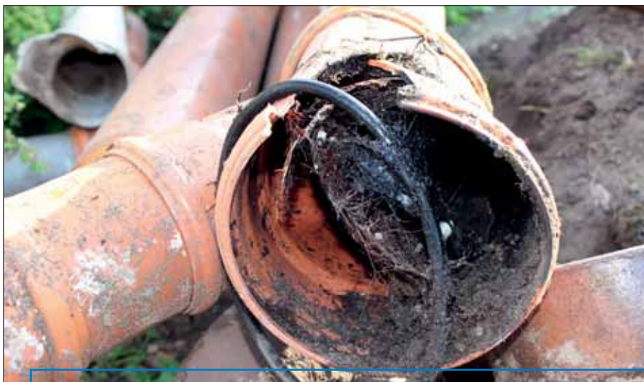
Durch Wurzeln verstopftes Abflussrohr.
