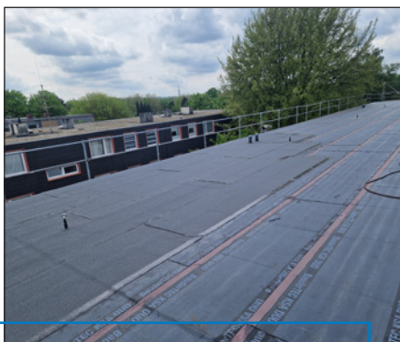
Zweilagige Flachdachabdichtung mit Bitumenbahnen oberhalb der Gefälledämmung. Für spätere Wartungsarbeiten wurden Sekuranten zur Personensicherung integriert.
