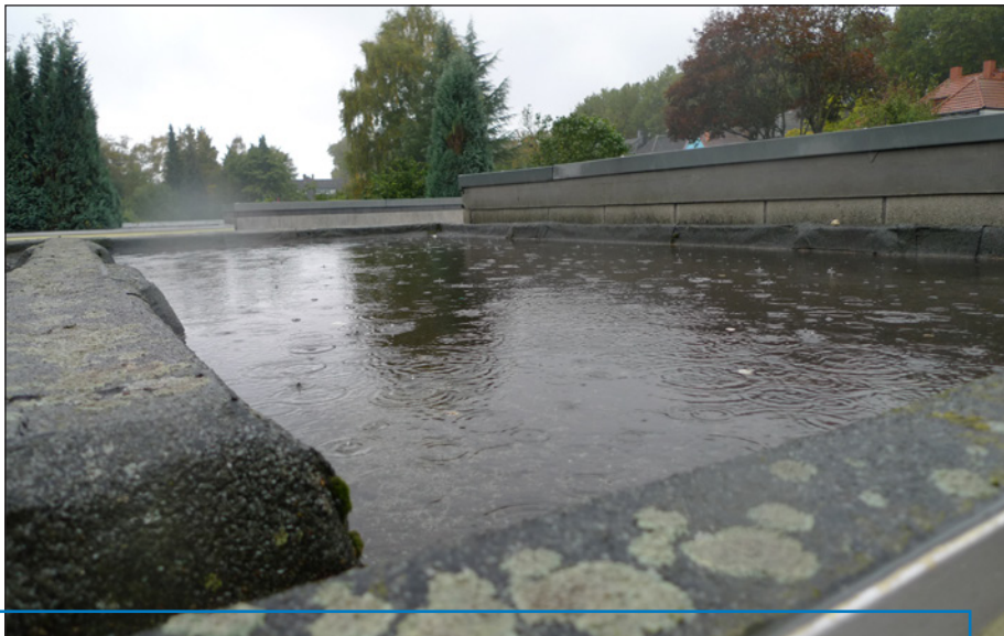
Bergbaubedingte Schiefelage verursacht eine Gefällestörung mit Stauwasserbildung.
