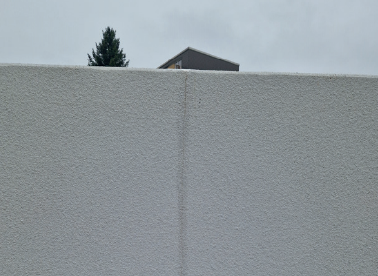
Schwindriss in Außenwand
