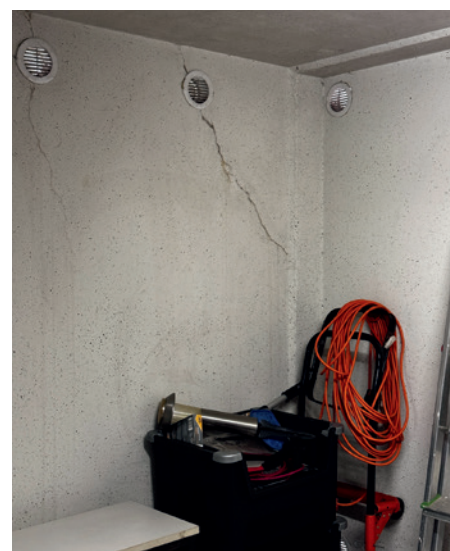
Schubrisse in Außenwand
