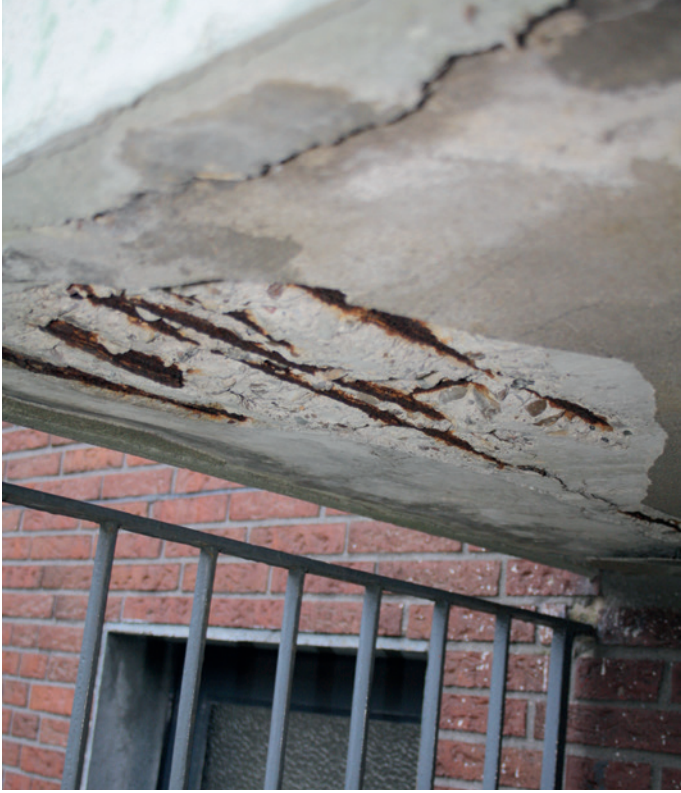
Betonabplatzungen an einer Balkonunterseite durch Bewehrungskorrosion
