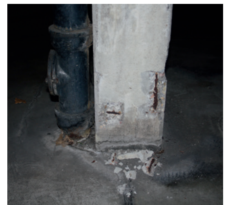
Bewehrungskorrosion an einer Stahlbetonstütze
