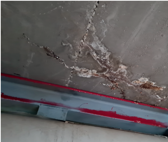
Fortgeschrittene Korrosion durch Salzeintritt
