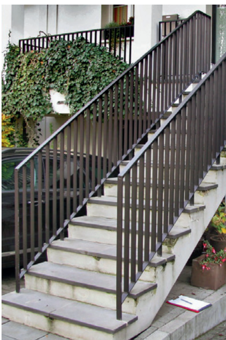
Verschmutzung/Vermoosung der verputzten Setzstufen und Treppenwange
