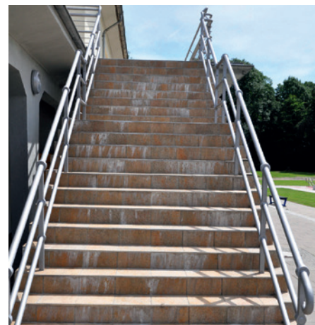
Stufenanlage mit Kalkausblühungen auf dem Fliesenbelag
