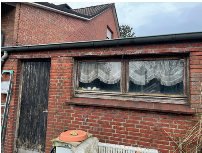
Korrodierte Stahlsturz über Fenster und Tür
