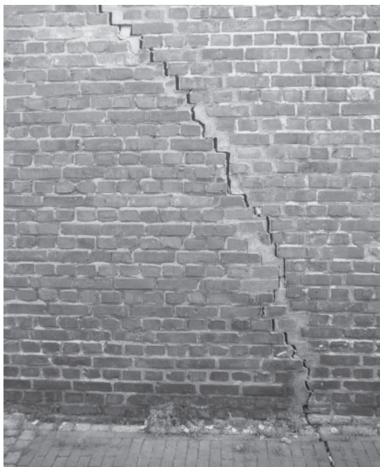
Bild 3. Neue Rissbildung neben alter Rissnarbe (Blick in Richtung Norden).
