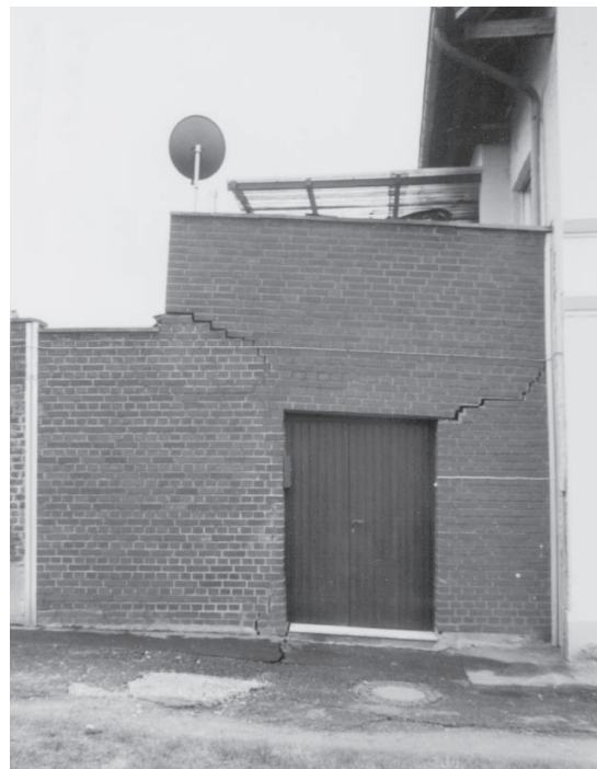
Bild 1. Alte Bebauung in Wassenberg mit ausgeprägtem Vertikalversatz (Blick in Richtung Süden).
