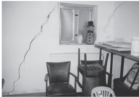
Bild 4. Schäden im Keller eines Neubaus aus dem Jahr 1999 (Blick in Richtung Süden).
