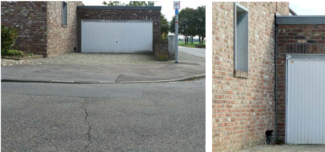
Abb. 4: Neue Rissbildung entlang einer früheren, abbaubedingten Erdstufe
