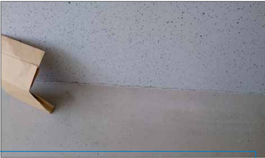
Typischer Riss in einer Fertiggarage im Übergang Boden/Wand. Der Briefumschlag dient dem Größenvergleich.
