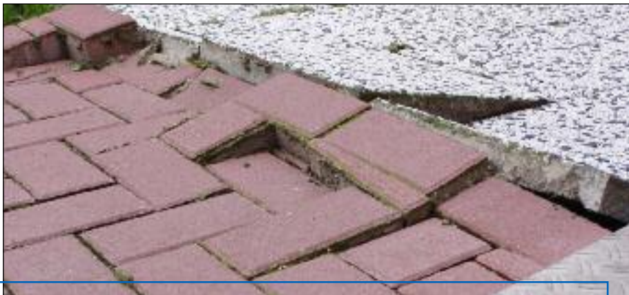
Schadhafte Pflasterfläche – Pressungsschaden.
