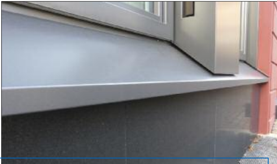
Gut gemacht: Wasser fließt über eine ausreichend ausladende Tropfkante ab.
