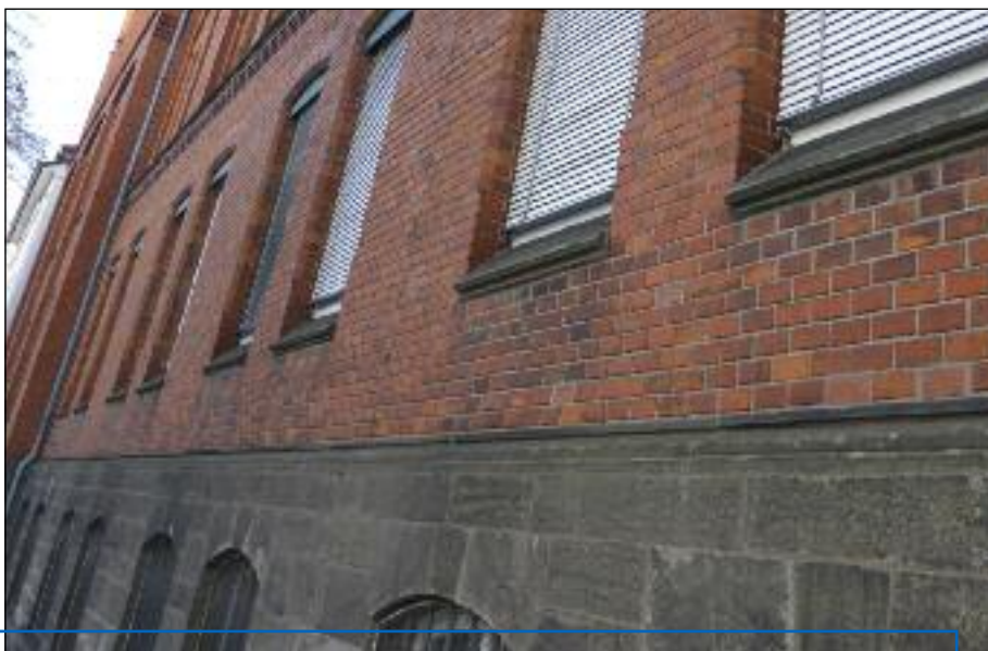
Trotz steiler Fensterbank und Wassernase sind deutliche Verfärbungen an der Brüstung zu erkennen.
