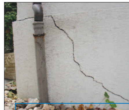
Abriss einer Gebäudeecke durch Bodenaustrocknung.
