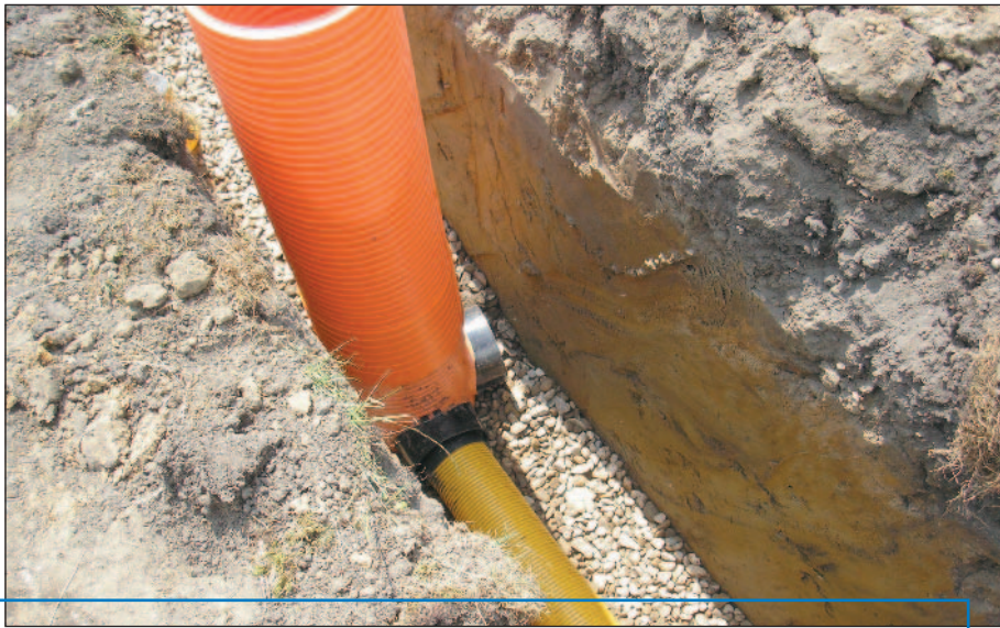
Revisionsöffnung an einer Felddrainageleitung.
