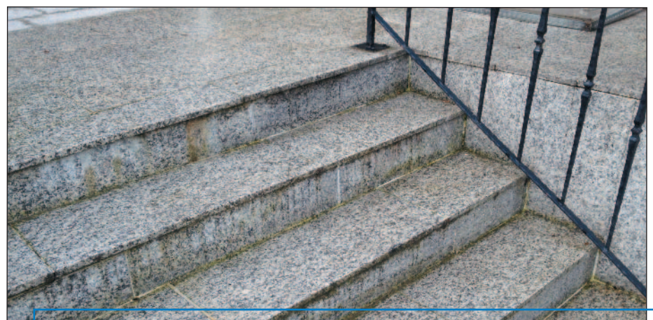
Treppe mit Vermoosung durch undichte Fugen.
