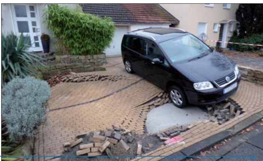
Beschädigte Pflasterfläche – hier ist nicht mangelhafte Erstellung sondern ein bergbaubedingter Tagesbruch die Ursache.
