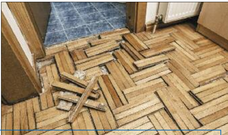
Bauteile aus Holz, insbesondere Parkettfußböden, sind bei einem Wasserschaden meist besonders betroffen.
