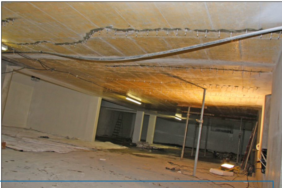
Rissverpressung bei einer Betondecke. Die sog. Schraubpacker werden später wieder entfernt und die Deckenansicht nachgearbeitet.
