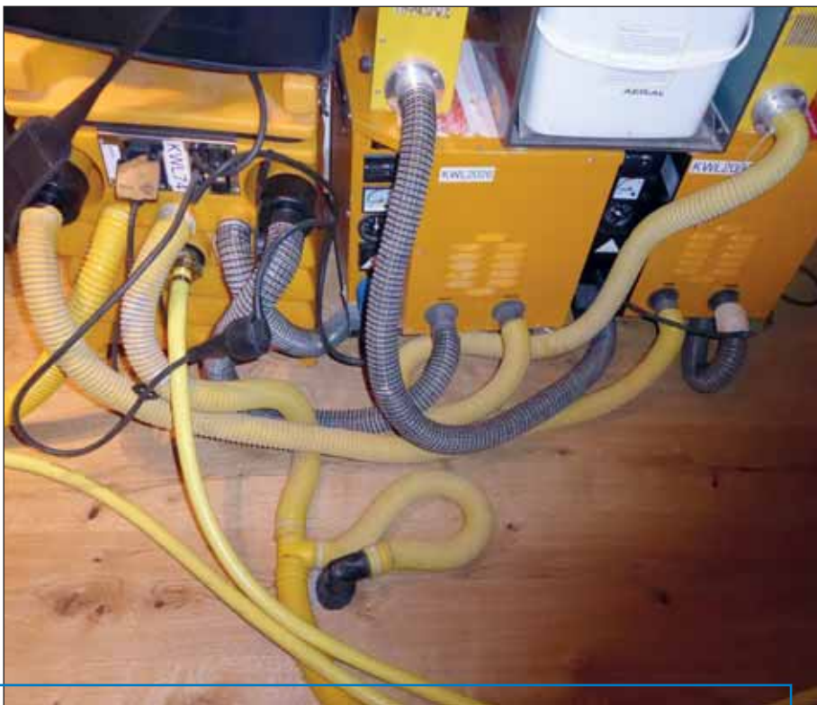
Trocknungsmaßnahme in einem Neubau nach Wassereintritt in die Dämmstoffebene.
