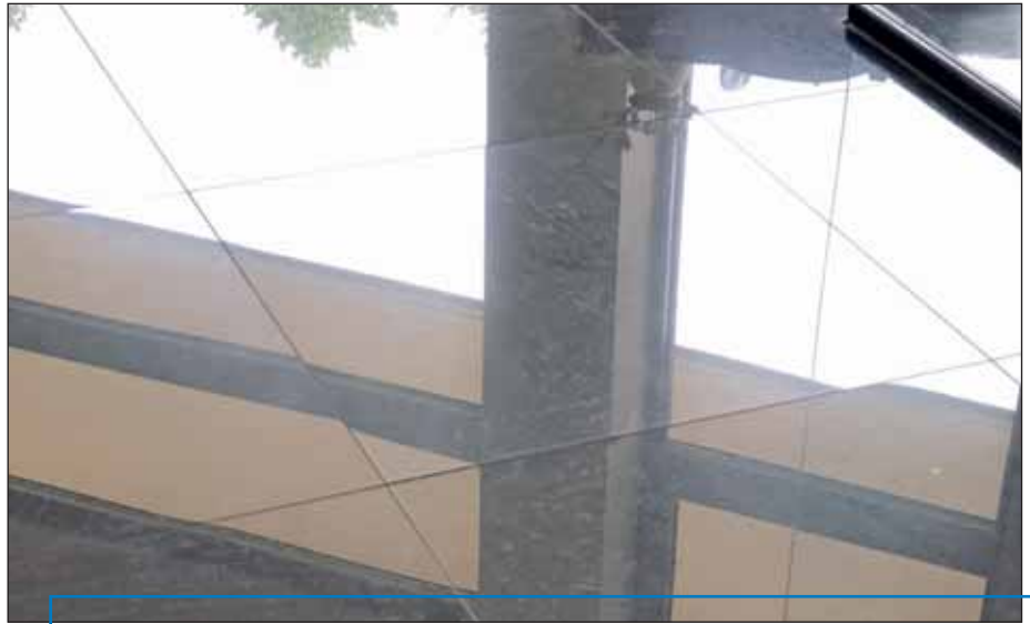
Werden Fliesen nicht eben verlegt, ergibt sich ein gestörtes Spiegelbild.
