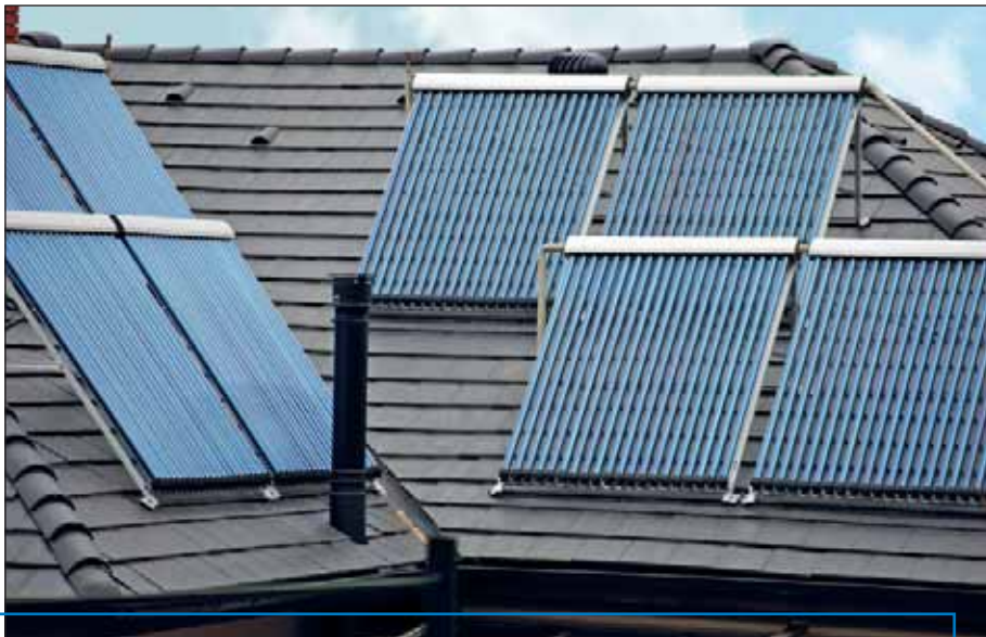
Solarthermieanlage mit optimierter Ausnutzung der Dachfläche.
