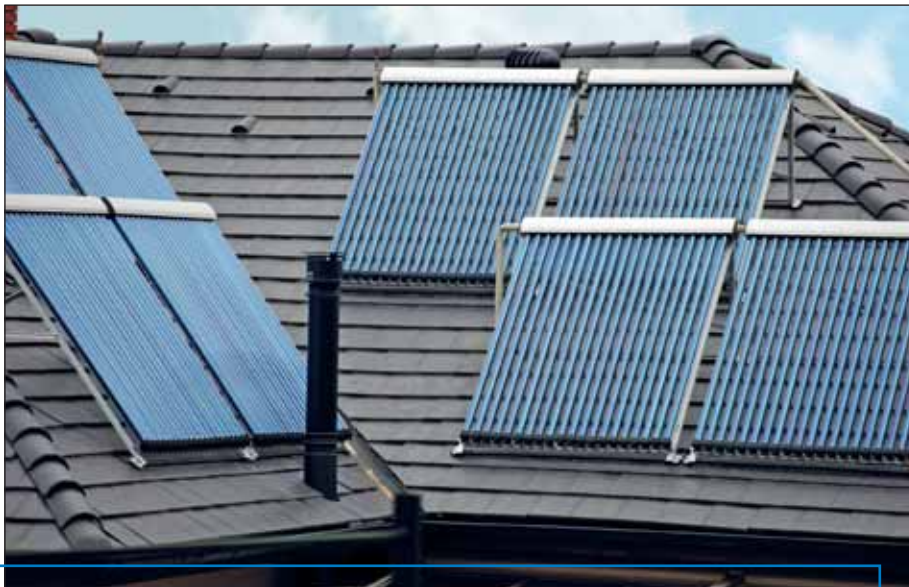
Solarthermieanlage mit optimierter Ausnutzung der Dachfläche.
