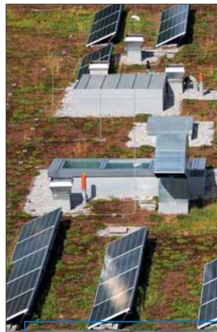
Optimiert: Dachbegrünung und Solaranlage.
