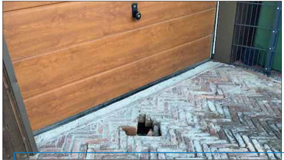
Bei diesem Tagesbruch handelt es sich um einen Erdfall über einer Grundleitung.
