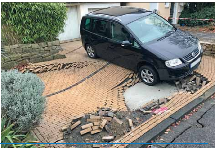
Das Ergebnis eines außergewöhnlichen bergbaubedingten Tagesbruchs.
