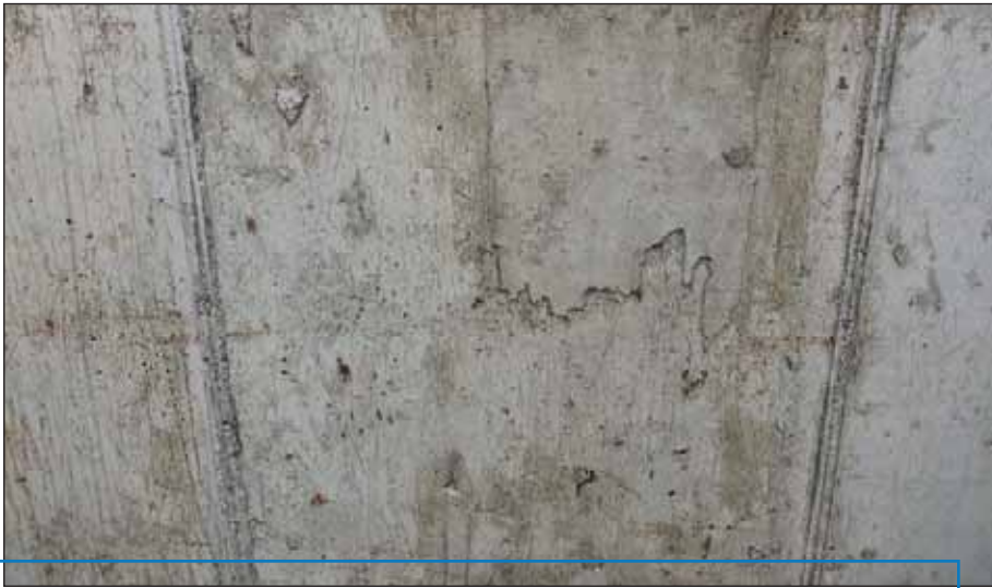
Diese Sichtbetonfläche entspricht sicher nicht dem gewünschten Aussehen.
