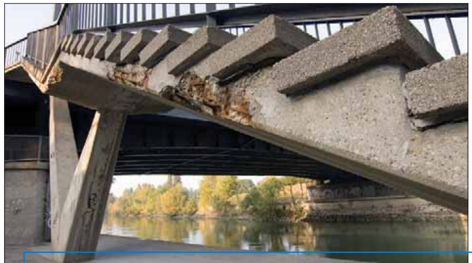
Schadhafte Sichtbetontreppe, die dringend einer Sanierung bedarf.
