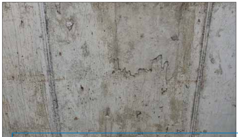
Diese Sichtbetonfläche entspricht sicher nicht dem gewünschten Aussehen.
