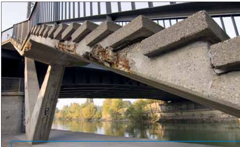
Schadhafte Sichtbetontreppe, die dringend einer Sanierung bedarf.
