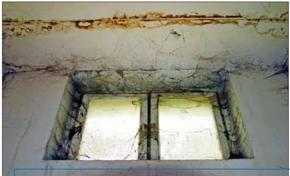
Freiliegender Bewehrungsstahl in einer Kellerdecke. Hier ist Sanierung anstelle Kosmetik gefragt.
