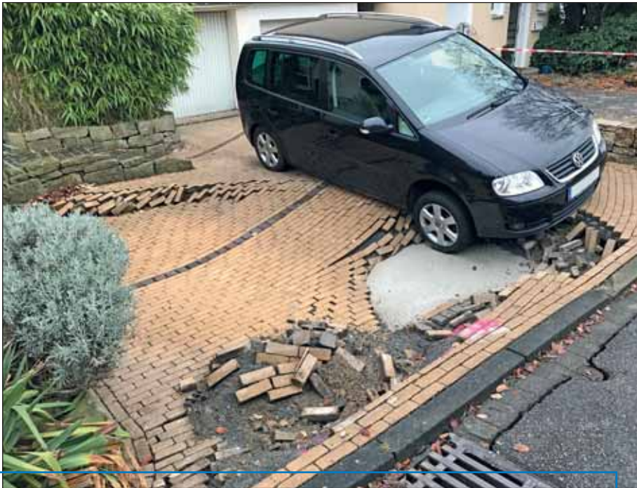
Das Ergebnis eines außergewöhnlichen bergbaubedingten Tagesbruchs.
