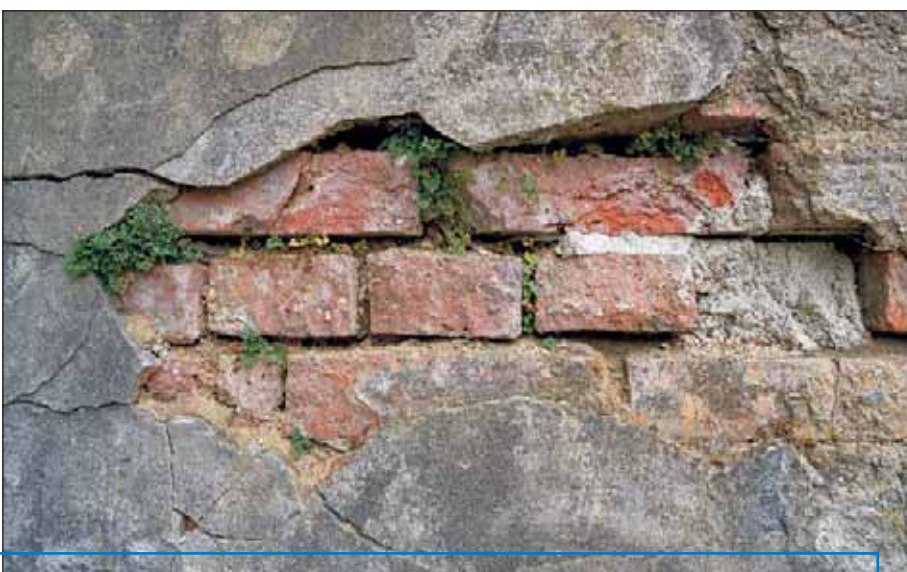
Witterungseinflüsse haben die Fugen dieser Wand bereits in Mitleidenschaft gezogen – eine baldige Sanierung zum Erhalt des Mauerwerks scheint dringend geboten.
