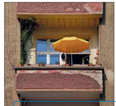
Sanierungsbedürftige Fassaden Ostberlin..
