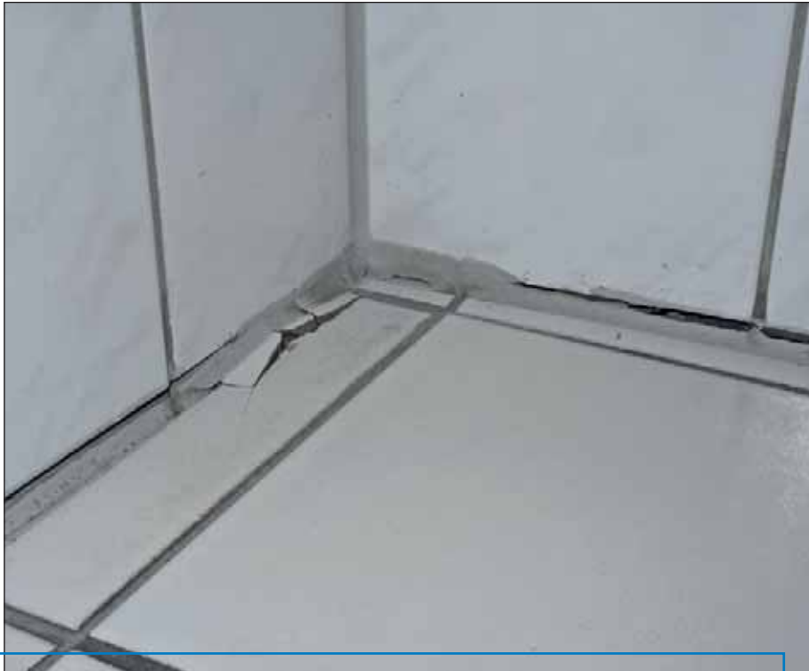
Die unzureichende Ausbildung einer Dehnungsfuge hat zu diesem Schaden im Übergang Wand-Fußboden geführt.
