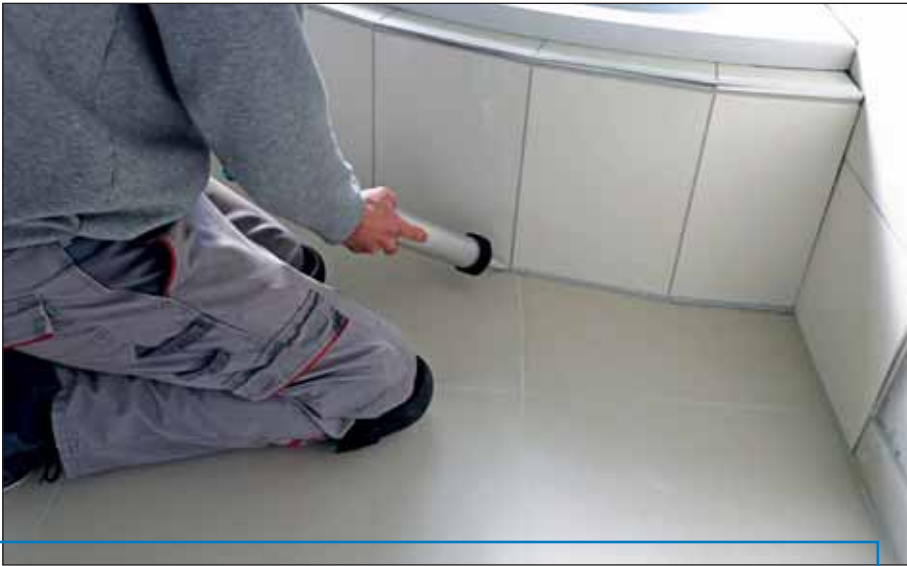
Fugenversiegelung in einem Bad.
