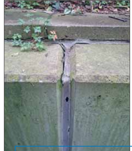
Auch sog. dauerelastisches Fugenmaterial bedarf der Wartung bzw. gelegentlichen Erneuerung.
