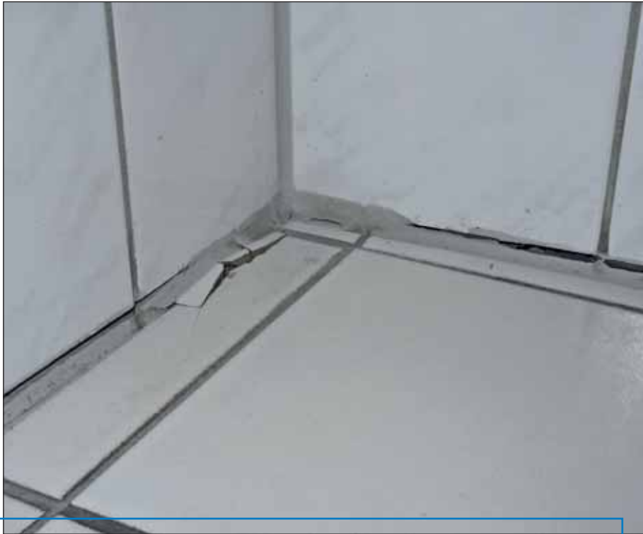
Verformungen des Estrichs führten zu der gerissenen Anschlussfuge im Übergang Wand – Fußboden.
