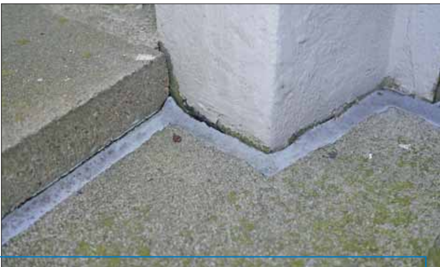
Erneuerungsbedürftige Fuge im Außenbereich.
