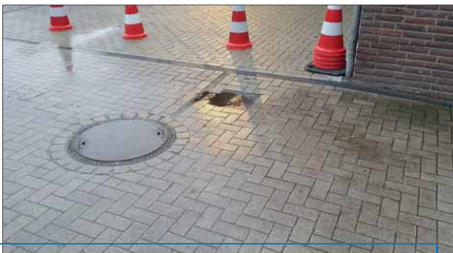
Pflasterabsackung oberhalb einer defekten Zulaufleitung.
