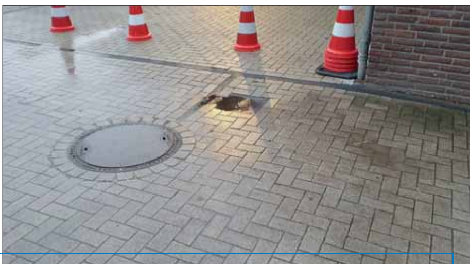
Pflasterabsackung oberhalb einer defekten Zulaufleitung.
