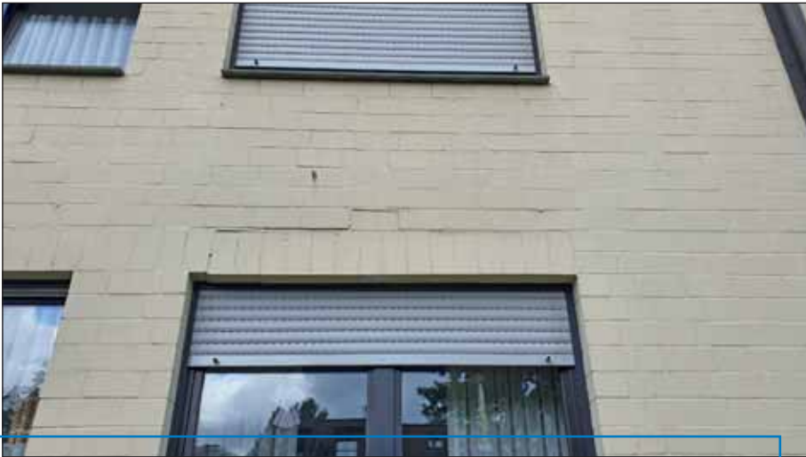
Fehlerhaft ausgeführter sog. Grenadierbogen.
