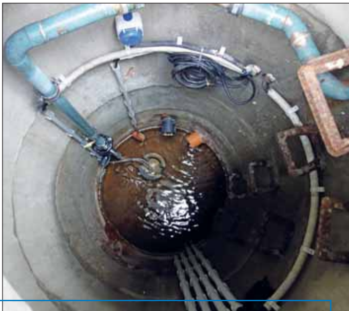
Drainagepumpe in einem Revisionssschacht.
