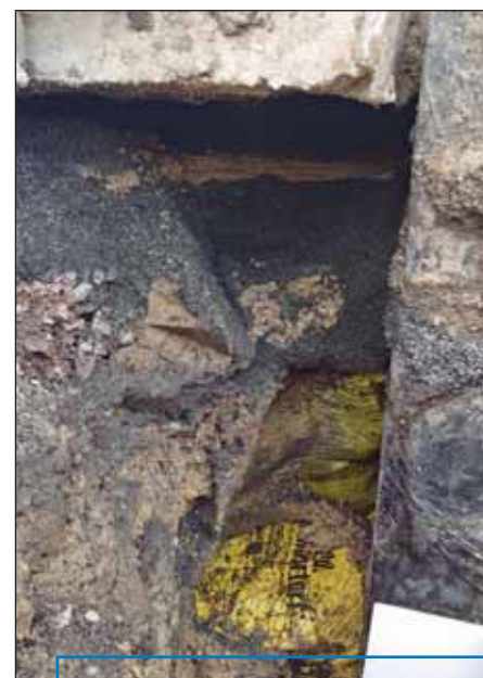
Polster aus Torfsäcken vor der Kelleraußenwand.
