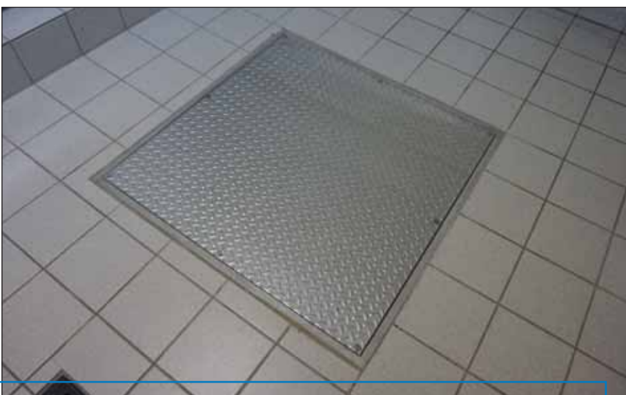
Bodengleiche Abdeckung eines Revisionsschachtes.
