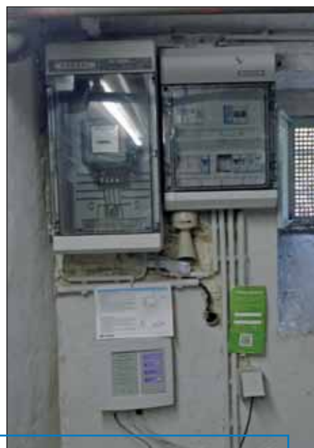
Steuerungseinheit mit Stromzähler.
