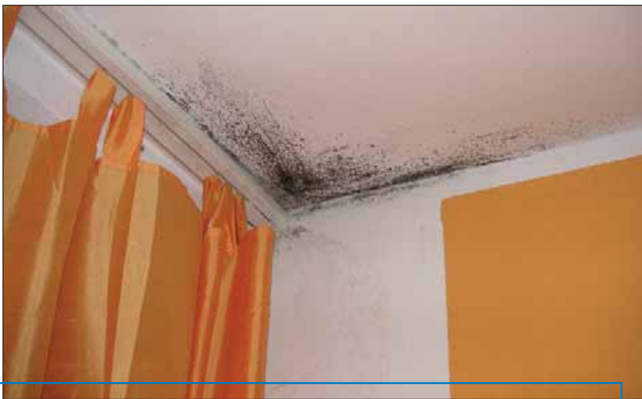
Schimmelpilzbildung unterhalb der Betondecke in einer Raumecke (geometrische Wärmebrücke).
