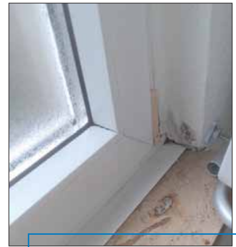
Kondensatbildung auf der Glasinnenoberfläche, Schimmelpilzbildung in der Fensterlaibung (geometrische Wärmebrücke).
