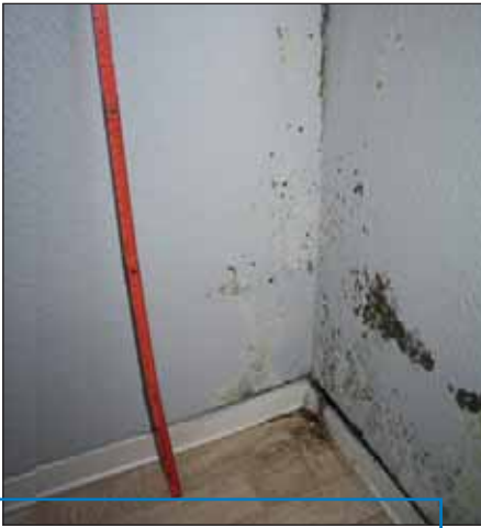
Außenwände in einem Anbau – Schimmelpilzbildung in der Raumecke und oberhalb der Sockelleisten (geometrische und konstruktive Wärmebrücken).
