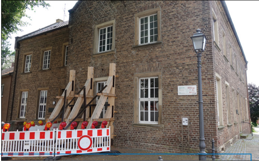
Beschädigtes Gebäude der Volkshochschule in Merzenich/Rheinland.
