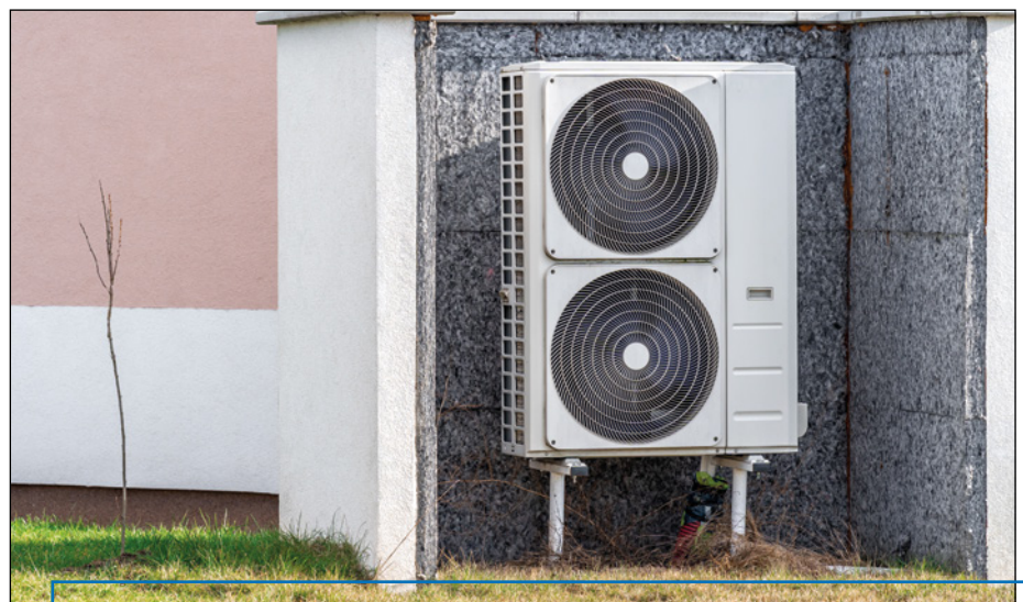
Luft-Wärmepumpe im Einfamilienhaus.
