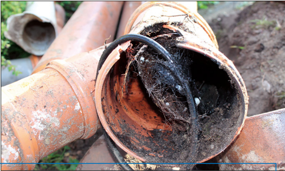
Durch Wurzeln verstopftes Abflussrohr.
