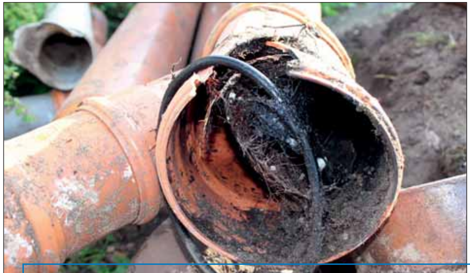
Durch Wurzeln verstopftes Abflussrohr.
