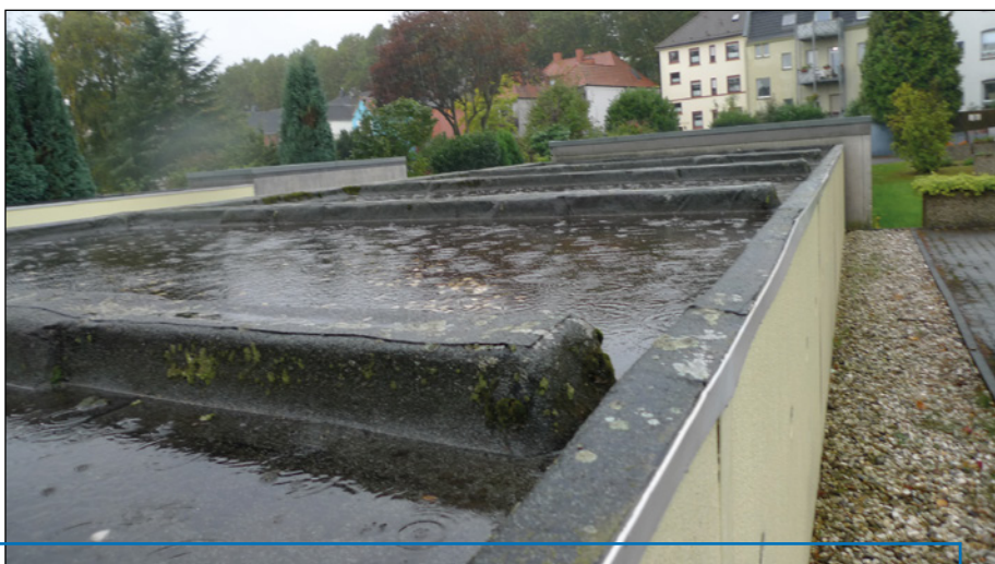
Bergbaubedingte Schiefelage verursacht eine Gefällestörung mit Stauwasserbildung.
