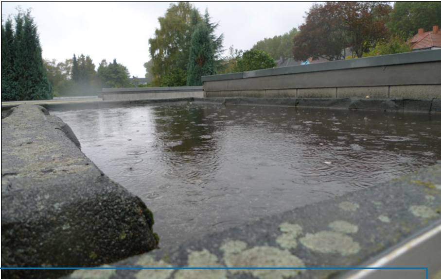
Bergbaubedingte Schiefelage verursacht eine Gefällestörung mit Stauwasserbildung.
