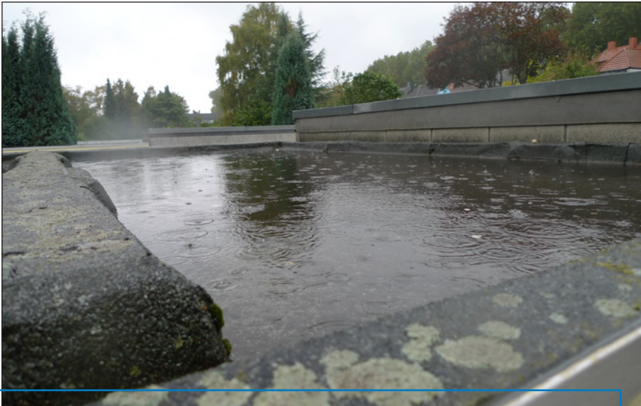
Bergbaubedingte Schiefelage verursacht eine Gefällestörung mit Stauwasserbildung.
