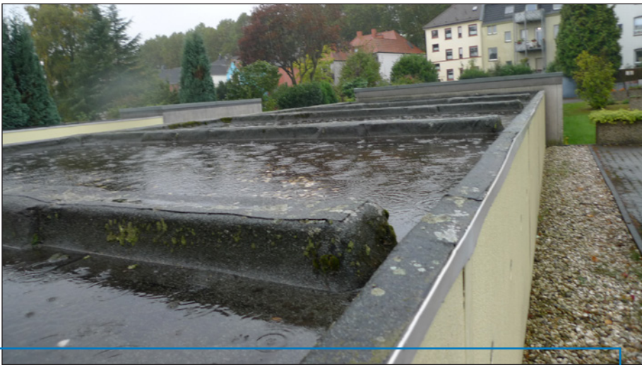
Bergbaubedingte Schiefelage verursacht eine Gefällestörung mit Stauwasserbildung.
