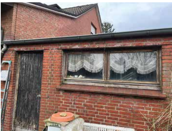
Korrodierter Stahlsturz über Fenster und Tür
