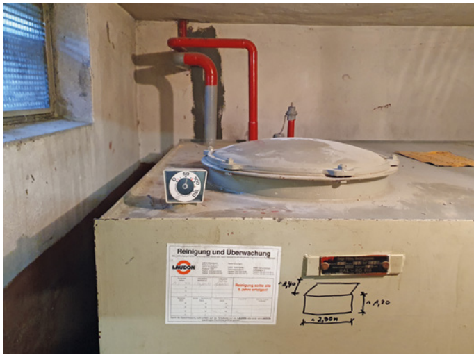
Stahltank für das Heizöl
