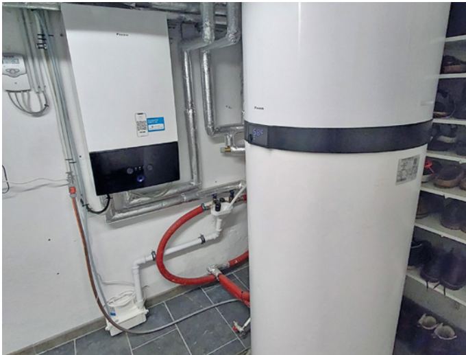
Steuerung Wärmepumpe (WP) und separater Wassertank mit aufgesetzter WP
