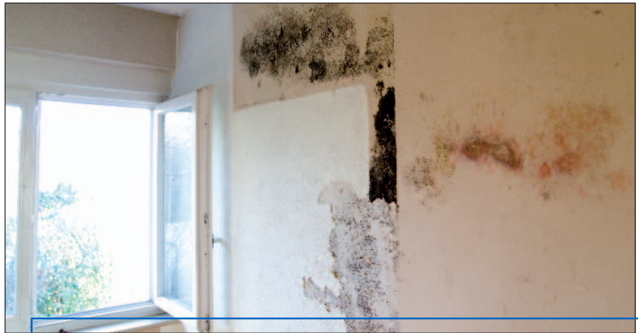
Schimmel – die Folge mangelhafter Lüftung.
